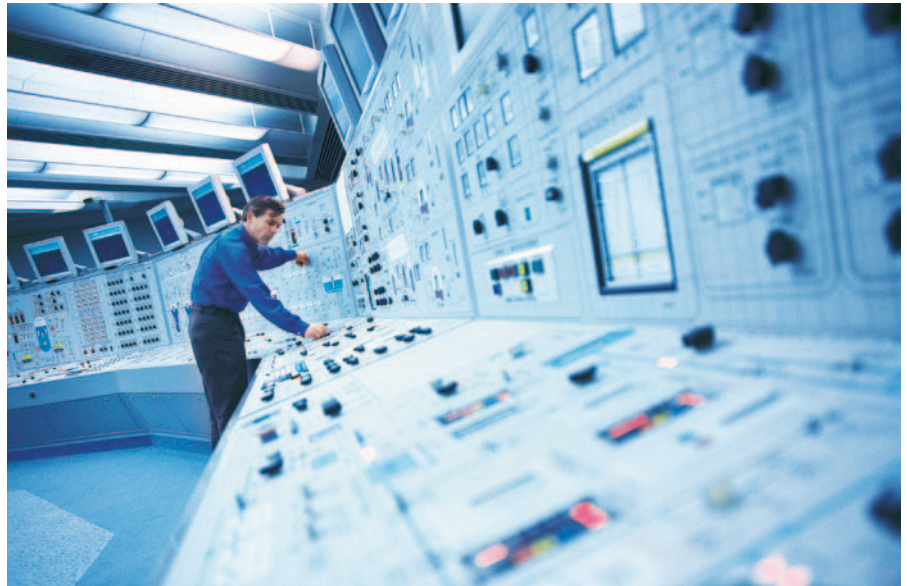
Надежное и безопасное отключение также и в комплексной коммутационной аппаратуре большой разрывной мощности
