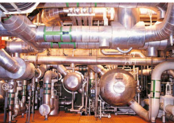
Оптимальное использование энергии, например, в сложных насосных установках
